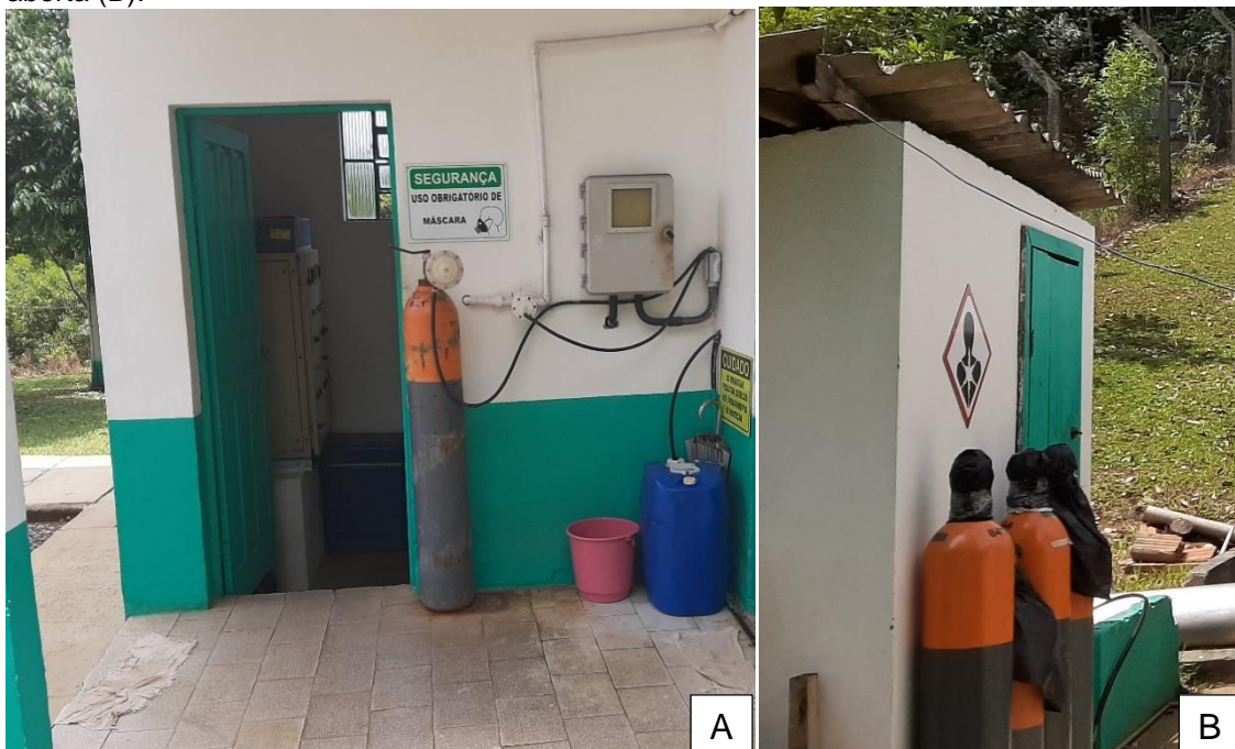
Figura 36: Cilindro de gás cloro em uso (A) e armazenamento dos cilindros de gás cloro em área externa aberta (B).
