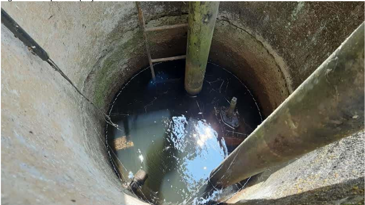
Figura 25: Poço de captação – Arroio dos Veados.
