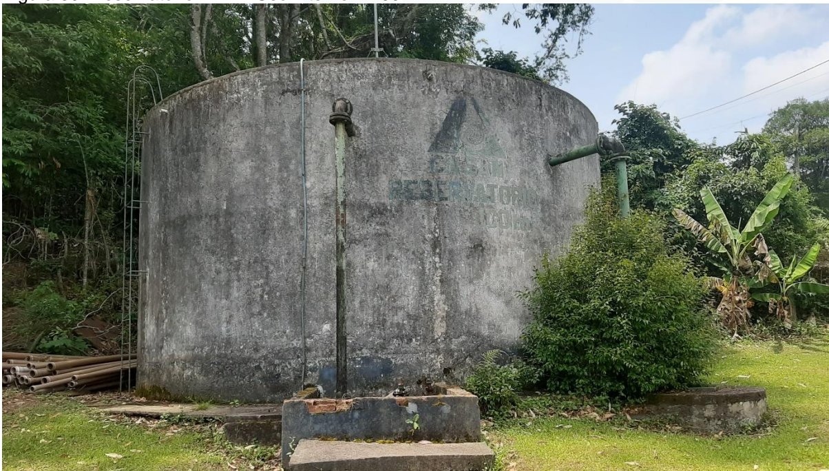
Figura 39: Reservatório ETA – Uso interno – 100 m 3 .
