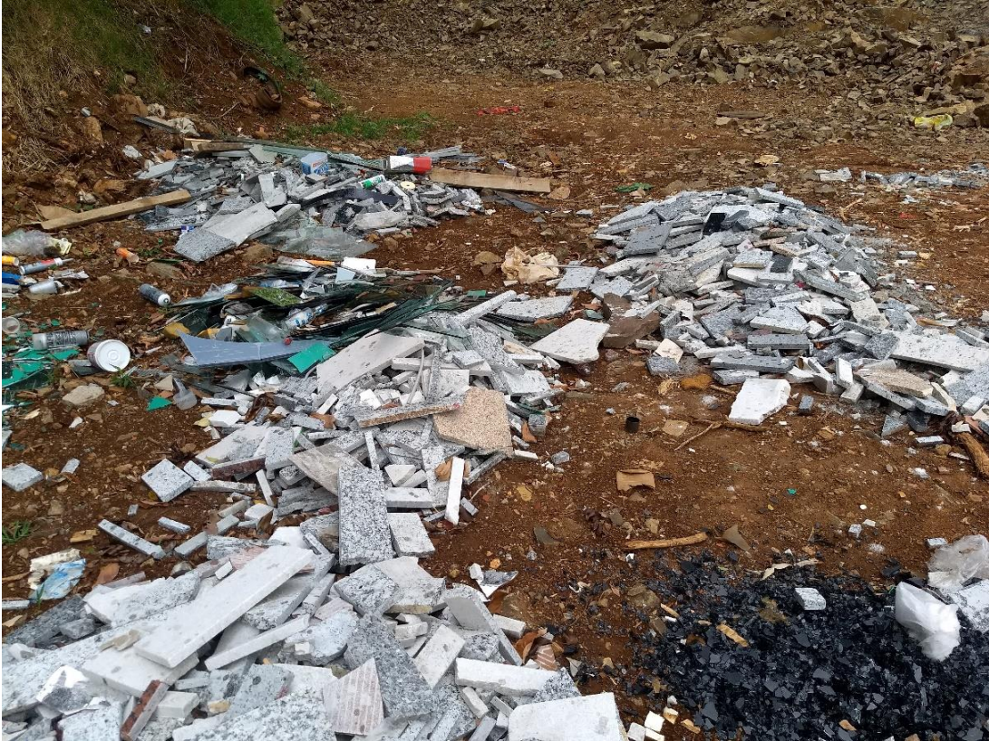
Figura 107: Resíduos de construção civil dispostos no local.
