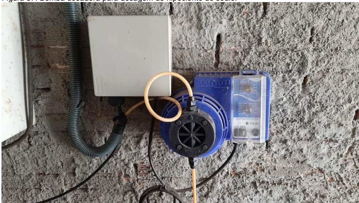
Figura 57: Bomba dosadora para dosagem de hipoclorito de sódio.
