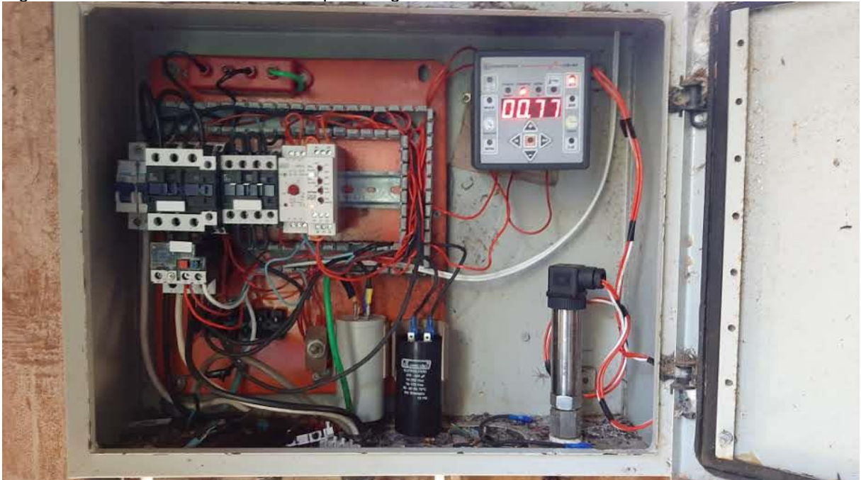
Figura 50: Painel da unidade de recalque de água intermediária.
