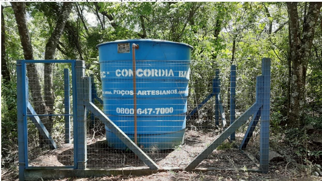
Figura 62: Centro de reservação R4 – quebra de pressão.
