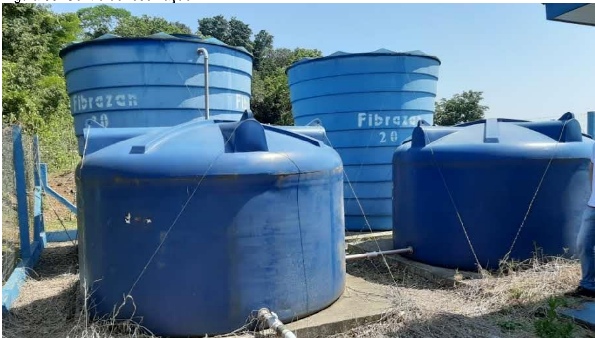
Figura 59: Centro de reservação R2.
