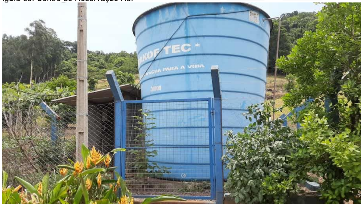
Figura 68: Centro de Reservação R3.
