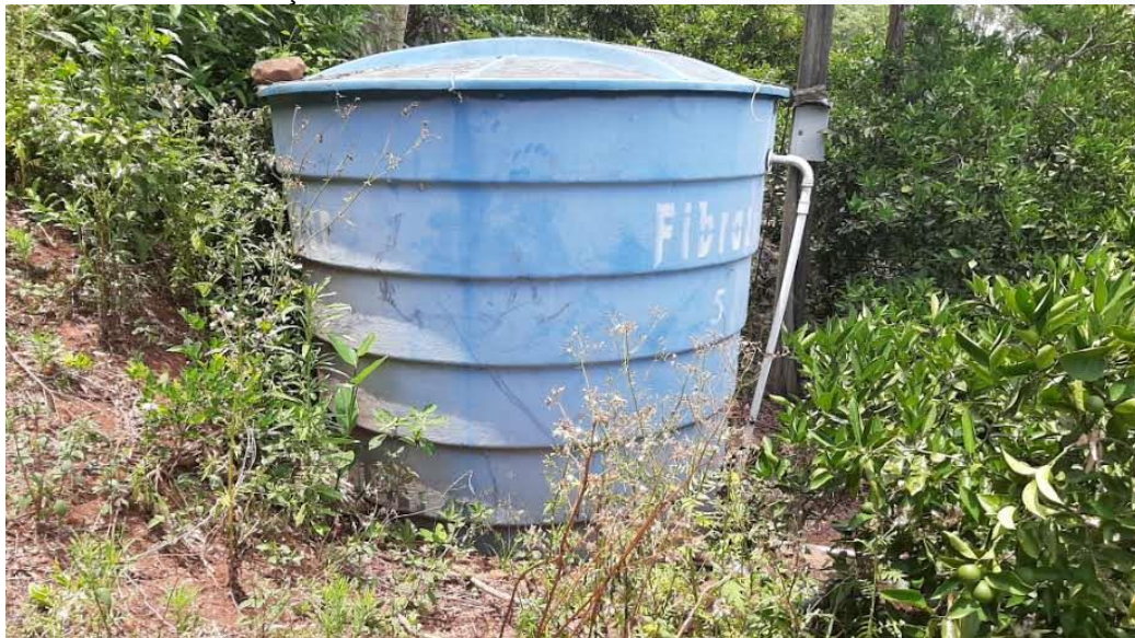
Figura 66: Centro de reservação R02.
