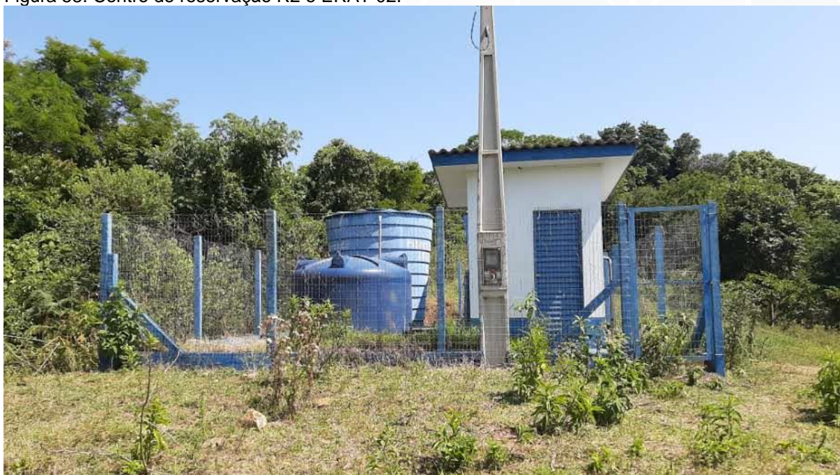
Figura 58: Centro de reservação R2 e ERAT 02.
