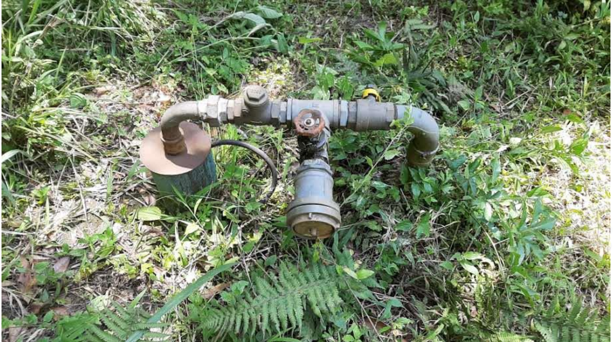
Figura 63 : Poço – Arroio do Meio.
