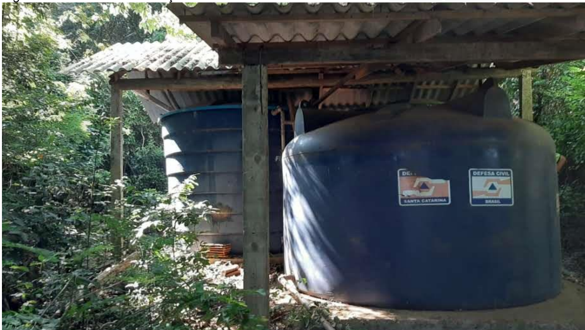
Figura 51: Centro de reservação R2.
