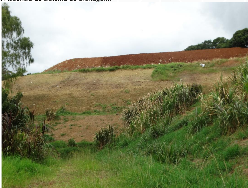
Figura 92: Ausência de sistema de drenagem.
