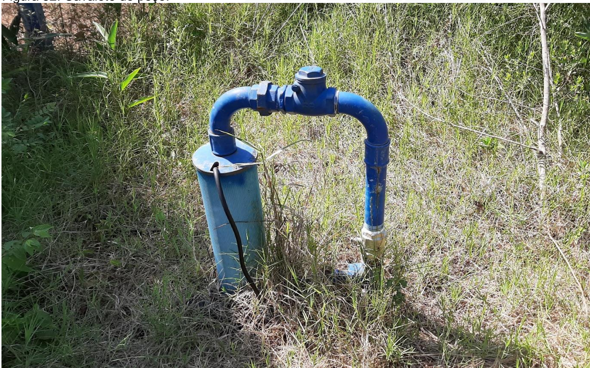
Figura 52: Cavalete do poço.
