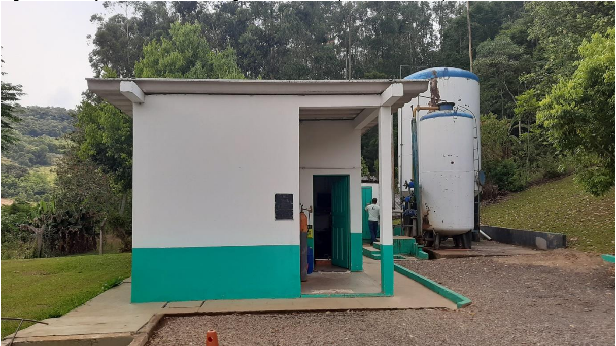
Figura 35: Estação de tratamento de água metálica compacta e casa de química.
