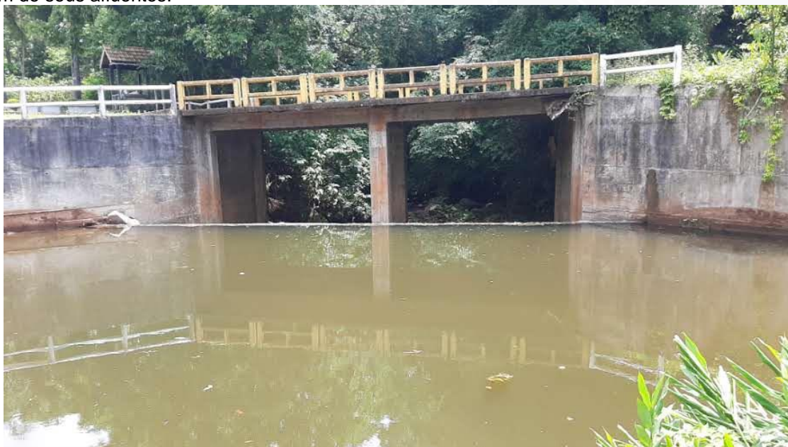
Figura 23: Barragem de nível para captação superficial de água no encontro entre o Arroio dos Veados e um de seus afluentes.
