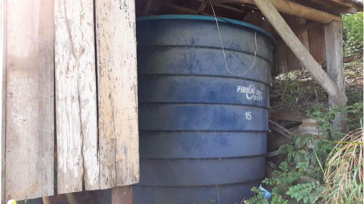
Figura 49: Centro de reservação R01 – PRFV 15m 3 .
