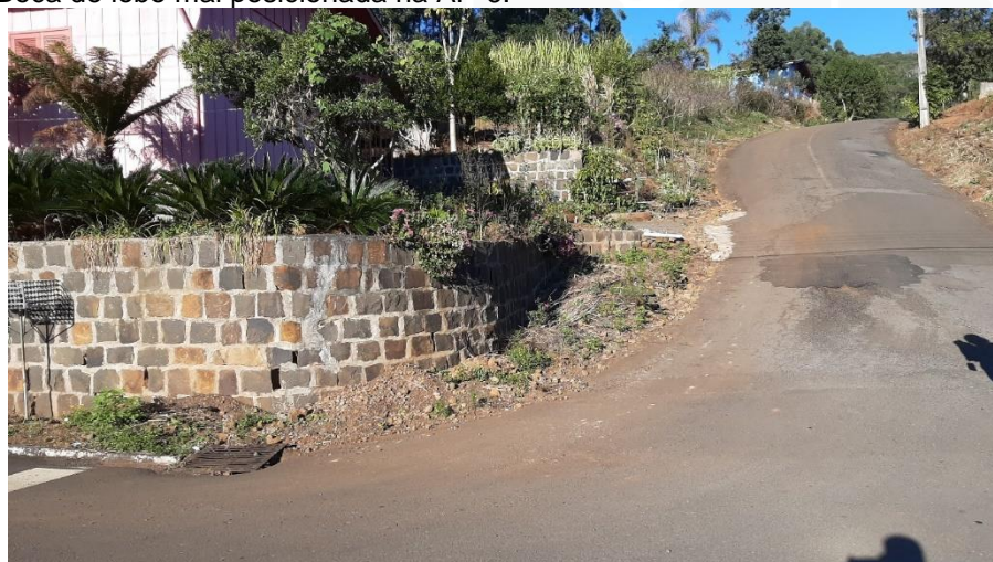
Figura 138: Boca de lobo mal posicionada na AP-6.
