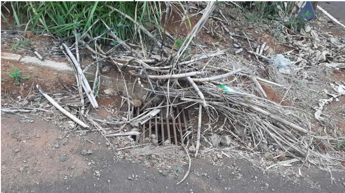
Figura 130: Boca-de-lobo sem manutenção localizada na área-problema.
