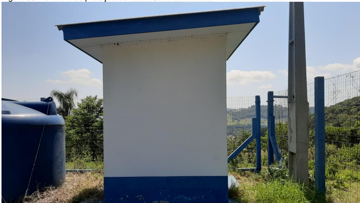
Figura 60: Estrutura de proteção da ERAT 02.
