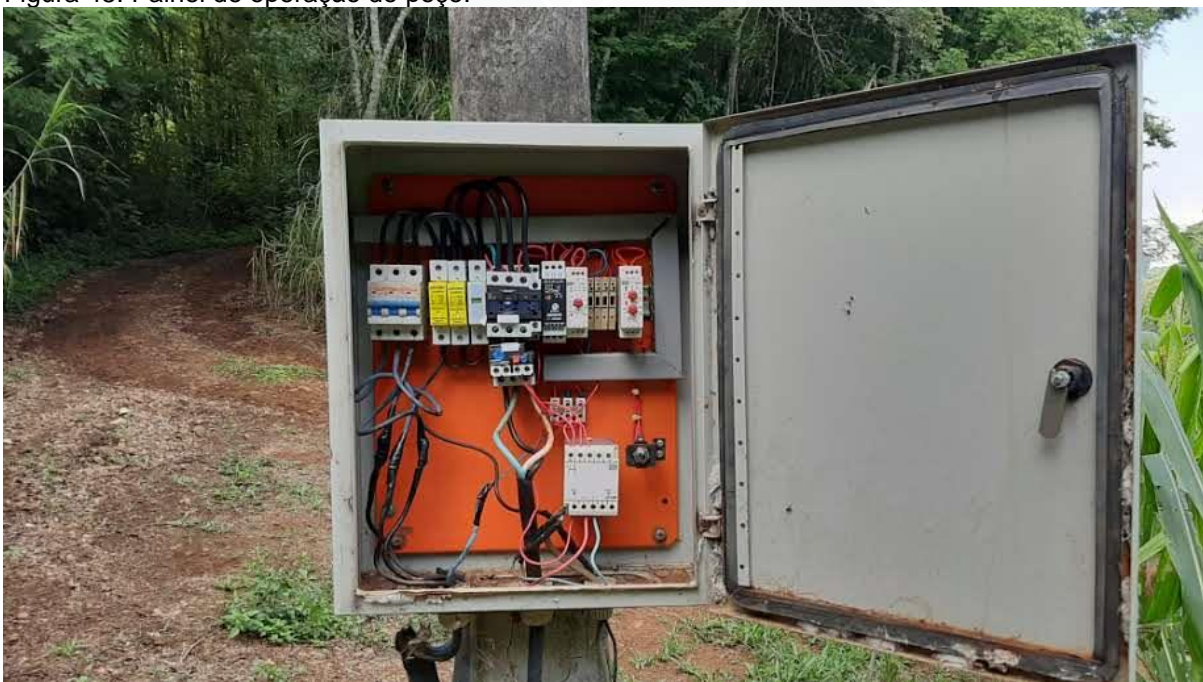
Figura 48: Painele de operação do poço.
