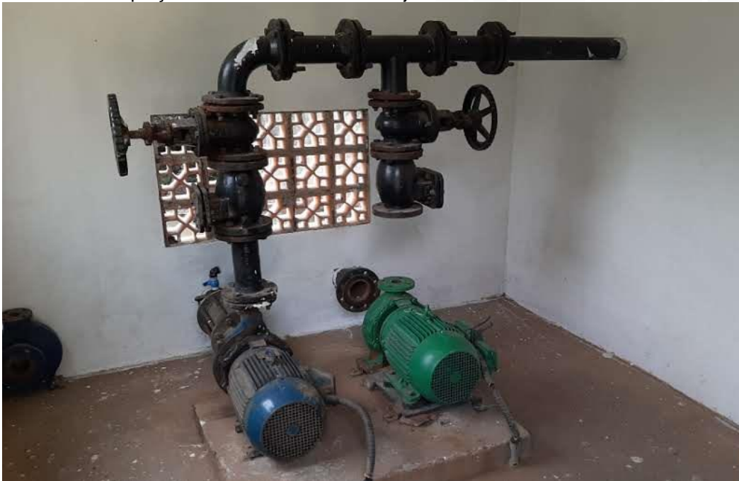
Figura 26: ERAB – Captação Arroio dos Veados – Conjunto motobomba.
