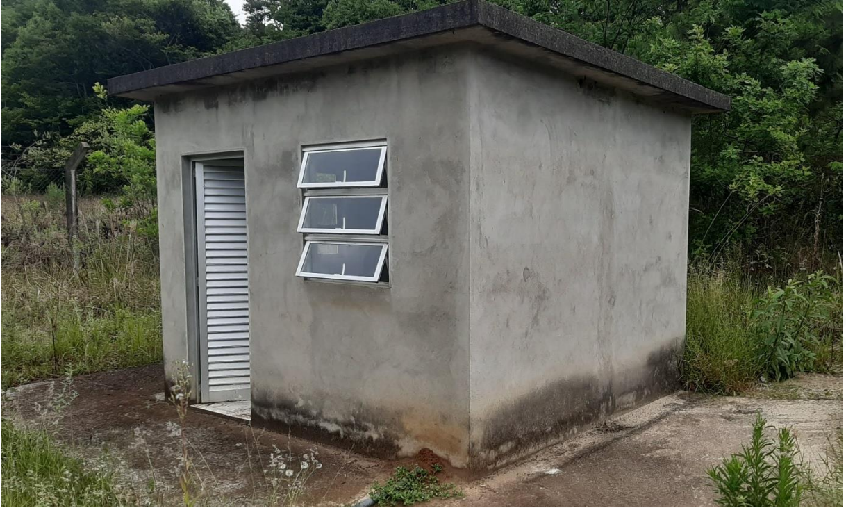
Figura 29: Estrutura de alvenaria para proteção cavalete poço sem pintura.
