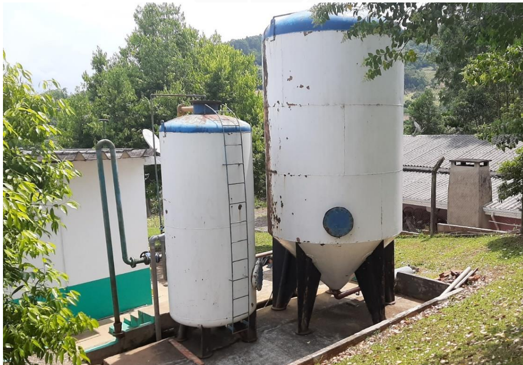
Figura 34: ETA – Floccodecantador e filtro.
