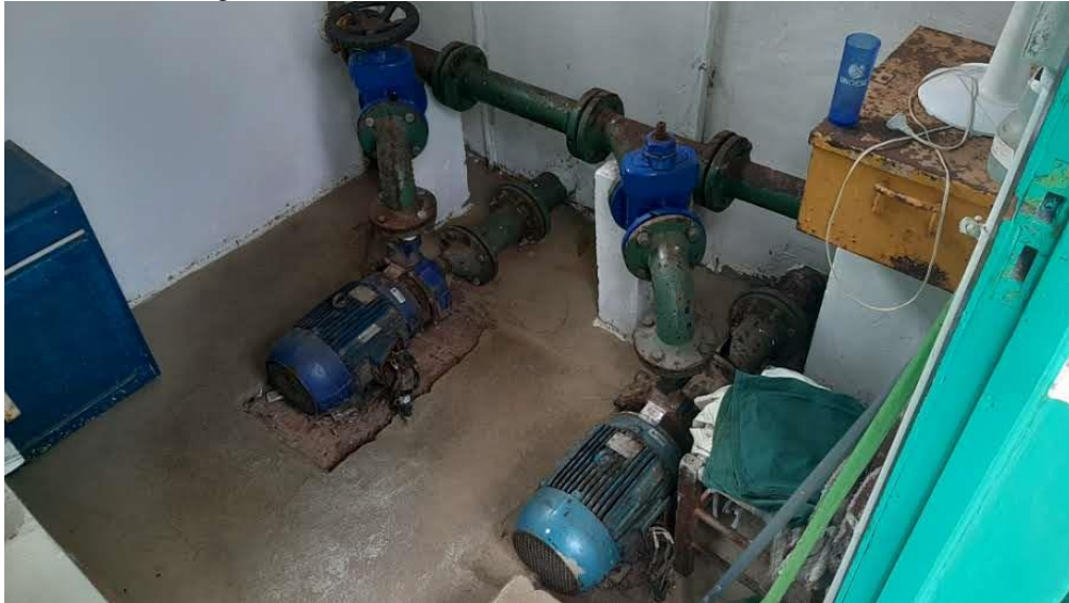
Figura 44: Elevatória de água tratada – 15 cv.
