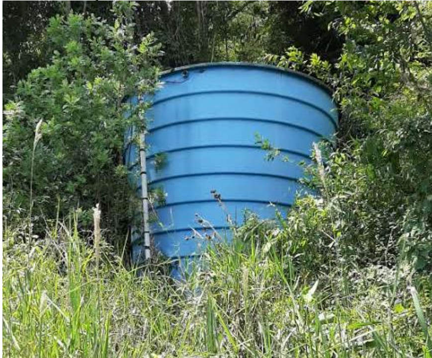
Figura 65: Centro de Reservação R01.
