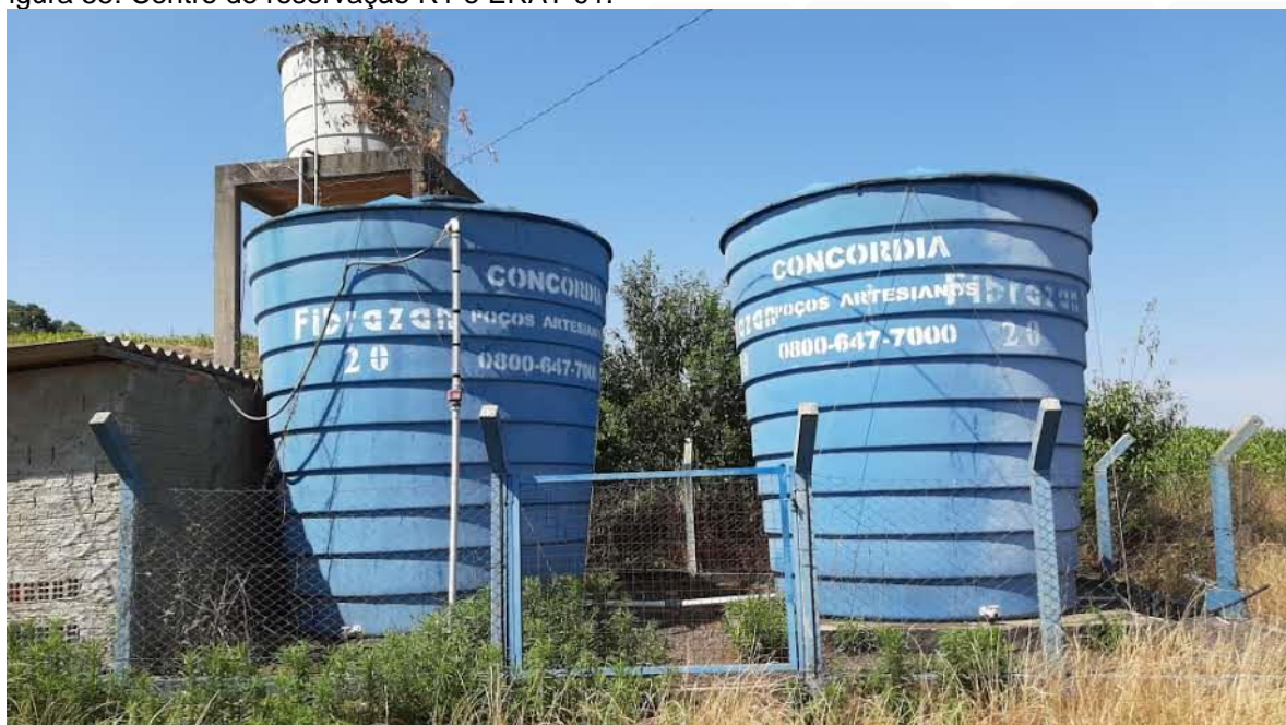
Figura 55: Centro de reservação R1 e ERAT 01.
