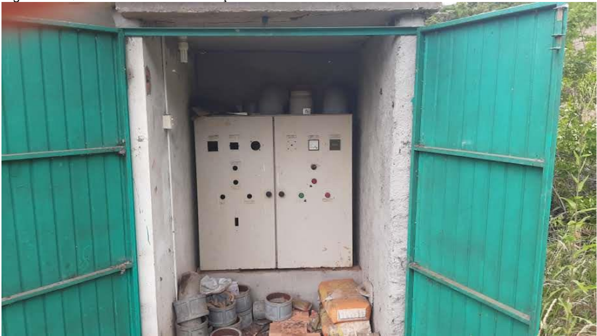
Figura 31: Quadro de comando do Poço 01.
