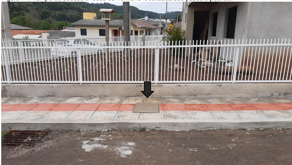
Figura 74: Tampa de acesso à fossa comunitária localizada sob passeio público.
